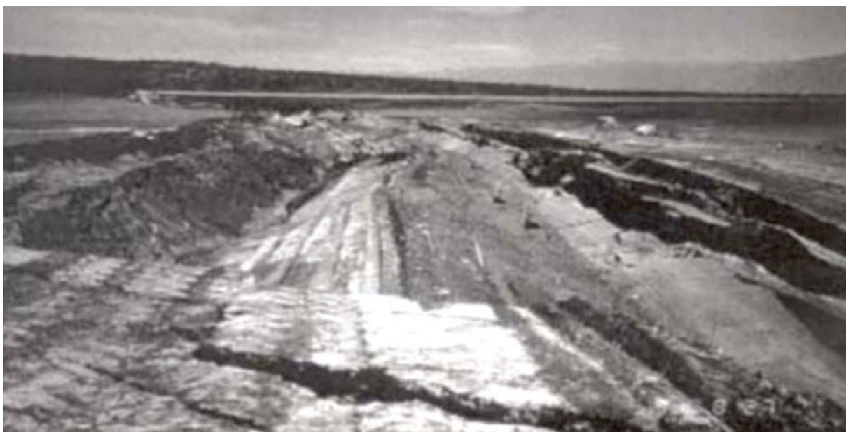
Figura 6 - Ruptura por liquefação da barragem de Sullivan (Davies et al. 2002, apud Freire Neto, 2009).
