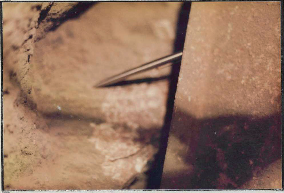
Foto 9 - Arco metálico no consolidado a las paredes del túnel.
