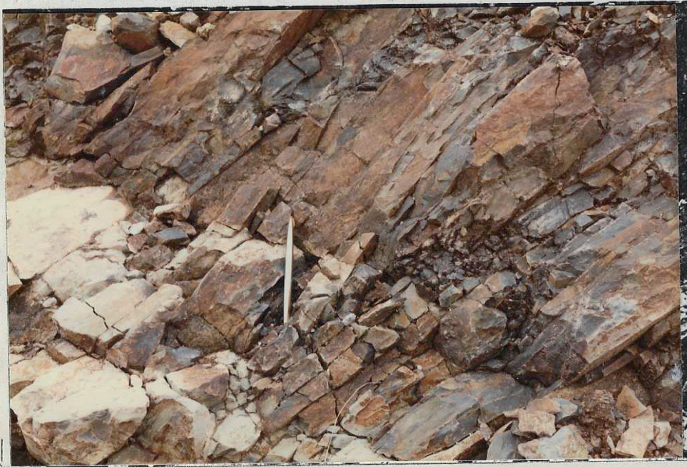
Foto 2 - Andesita : > 20 fracturas/m : F4; practicamente sana : A1 clase IV
