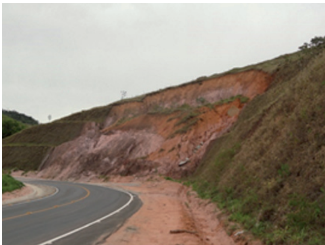
Figura 17 - Escorregamento em corte de estrada, expondo espesso regolito. Esta unidade de terreno apresenta alta suscetibilidade a deslizamentos planares ou escorregamentos rotacionais na massa de solo (entre os horizontes B e C ou em descontinuidades do saprolito). Rodovia ES-014, entre as localidades de Mimoso do Sul e Conceição do Muqui.
